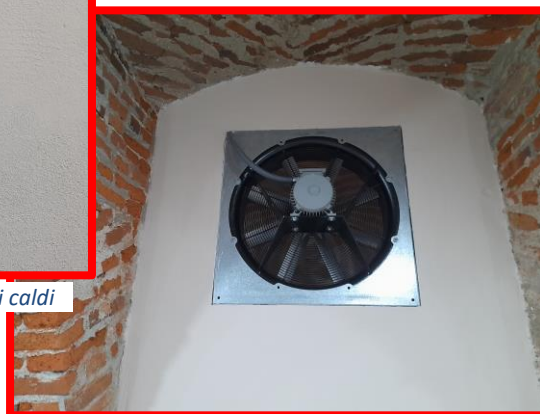
Ventola di aspirazione dei fumi caldi
